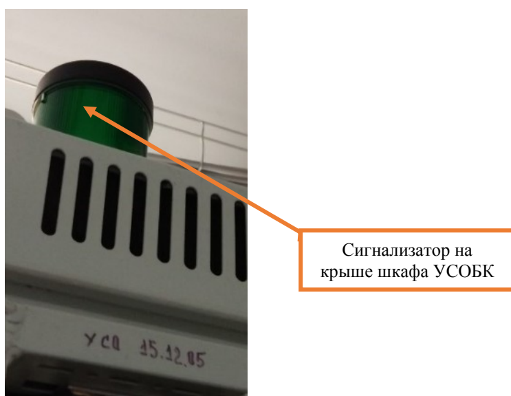
Рисунок 6. Сигнализатор на крышке шкафа УСОБК.
