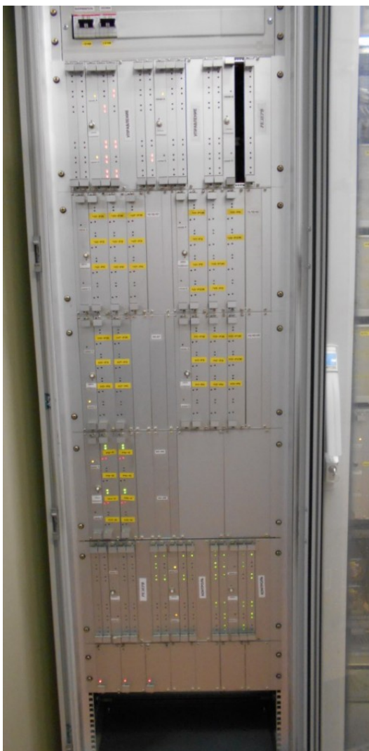
Рисунок 1. Размещение устройств сопряжения в шкафу ШУС.
